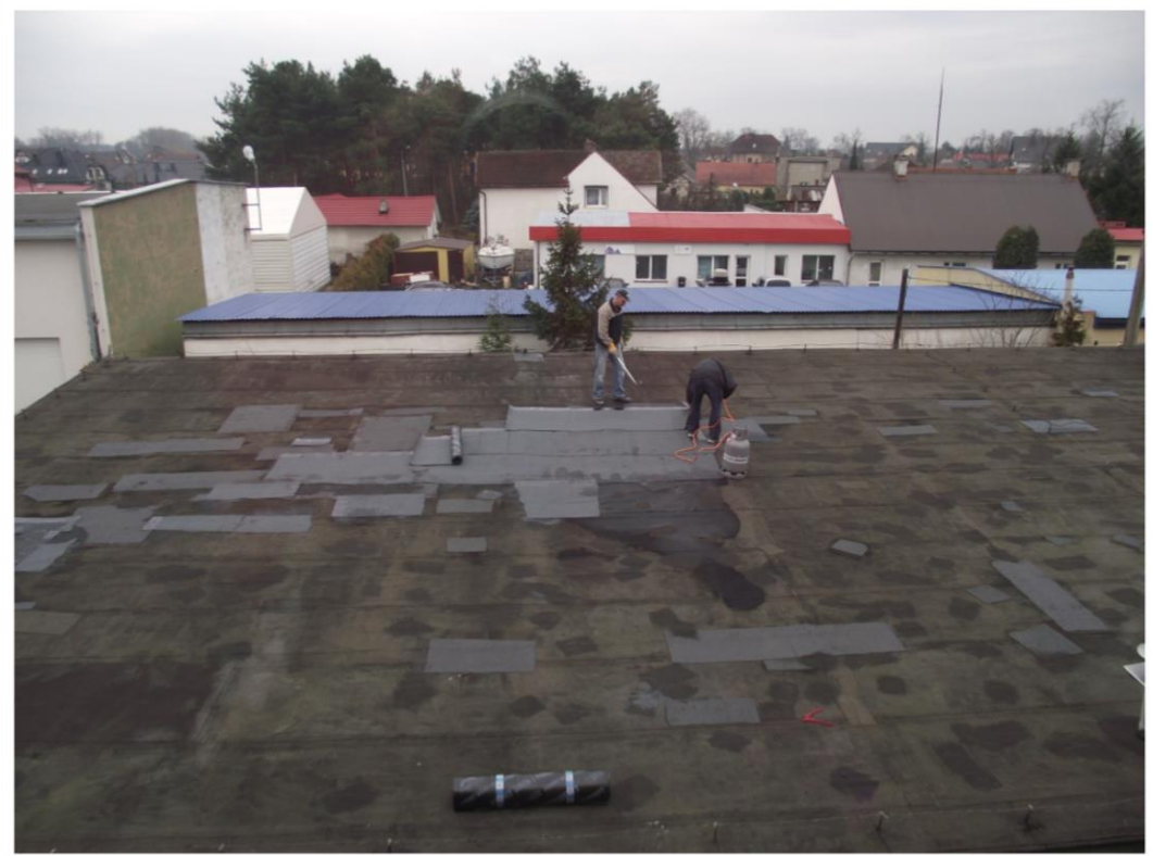
I JESZCZE WIĘCEJ DZIUR W DACHU – 15.12.2015
